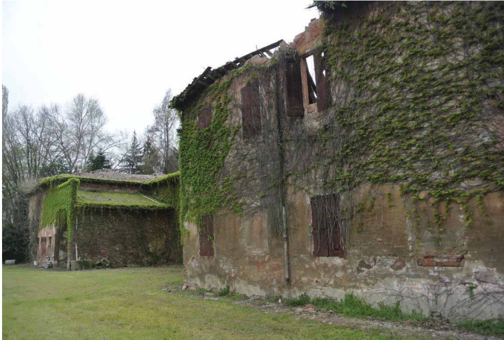
Foto 8: Prospetto est Crollo del coperto ligneo verso l'interno del fabbricato. Lesioni e crolli localizzati della muratura portante nella parte sommitale
