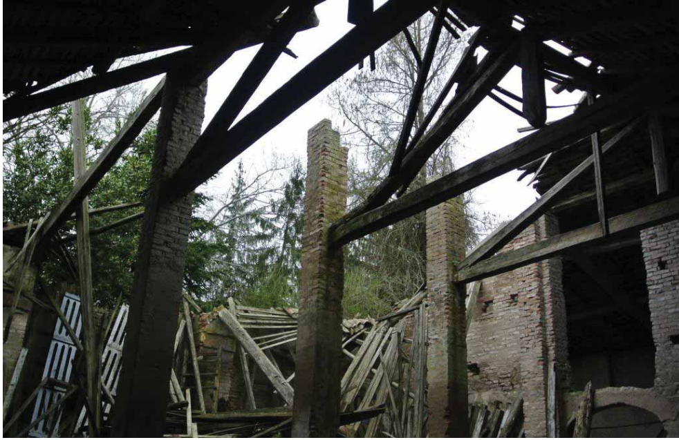
Foto 16: Crollo del coperto ligneo verso l'interno del fabbricato. Vista da un'apertura dell'androne di passaggio tra il fronte principale (verso la villa) ed il retro del fabbricato.
