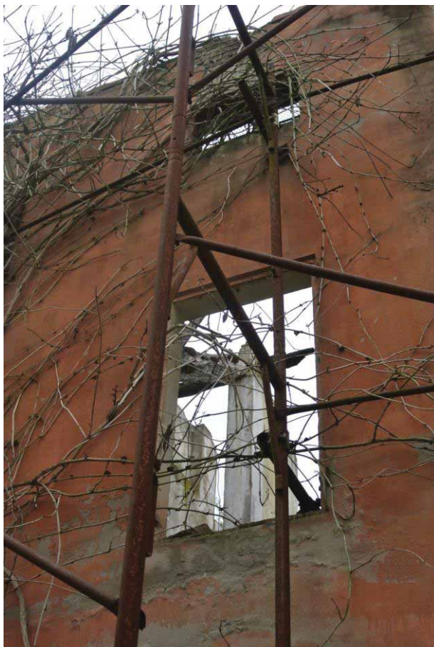
Foto 5: Prospetto ovest - particolare Crollo del coperto ligneo verso l'interno del fabbricato. Lesioni e crolli localizzati della muratura portante nella parte sommitale
