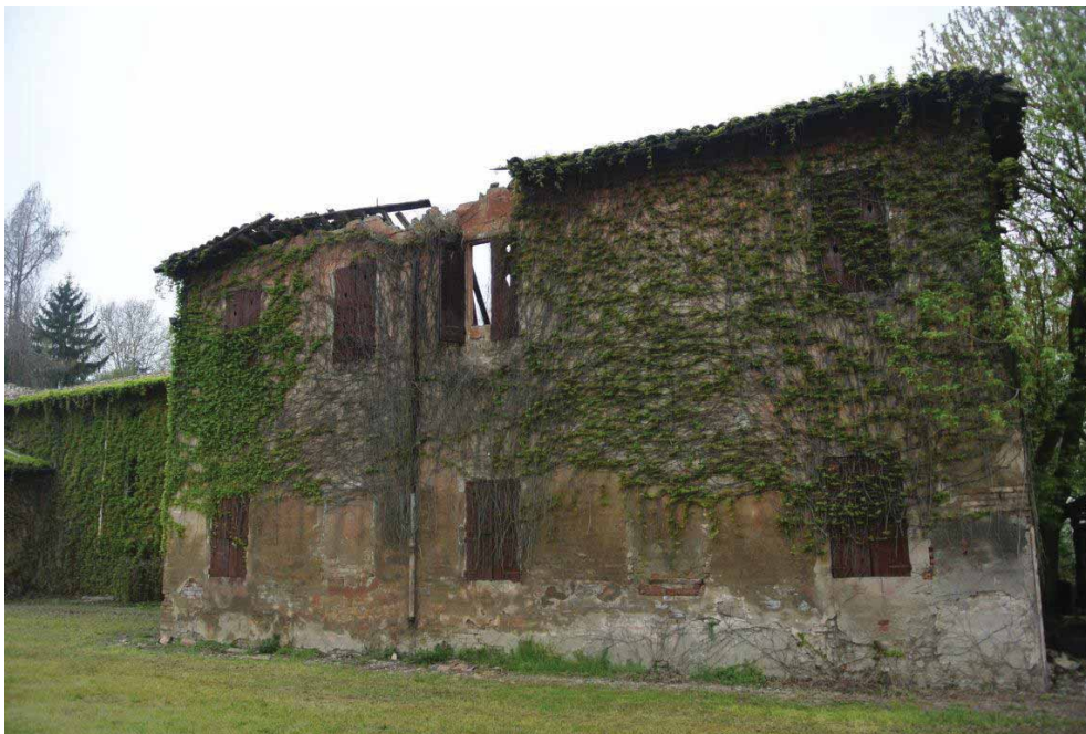
Foto 9: Prospetto est Crollo del coperto ligneo verso l'interno del fabbricato. Lesioni e crolli localizzati della muratura portante nella parte sommitale
