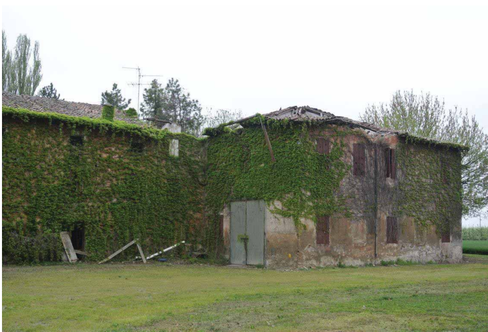
Foto 11: Prospetto est Crollo del coperto ligneo verso l'interno del fabbricato.
