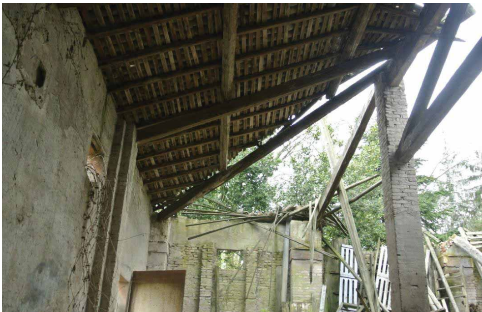
Foto 15: Crollo del coperto ligneo verso l'interno del fabbricato. Vista da un'apertura dell'androne di passaggio tra il fronte principale (verso la villa) ed il retro del fabbricato.
