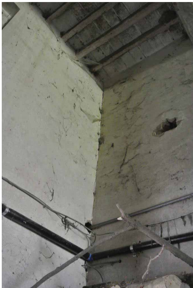
Foto 18: Distacchi tra pareti dell'androne di passaggio tra il fronte principale (verso la villa) ed il retro del fabbricato.
