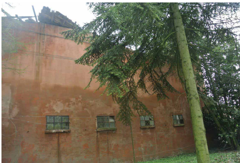
Foto 2: Prospetto sud Crollo del coperto ligneo verso l'interno del fabbricato
