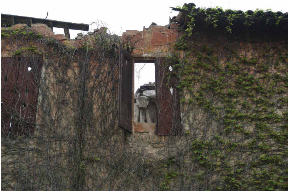
Foto 10: Prospetto est - particolare Crollo del coperto ligneo verso l'interno del fabbricato. Lesioni e crolli localizzati della muratura portante nella parte sommitale
