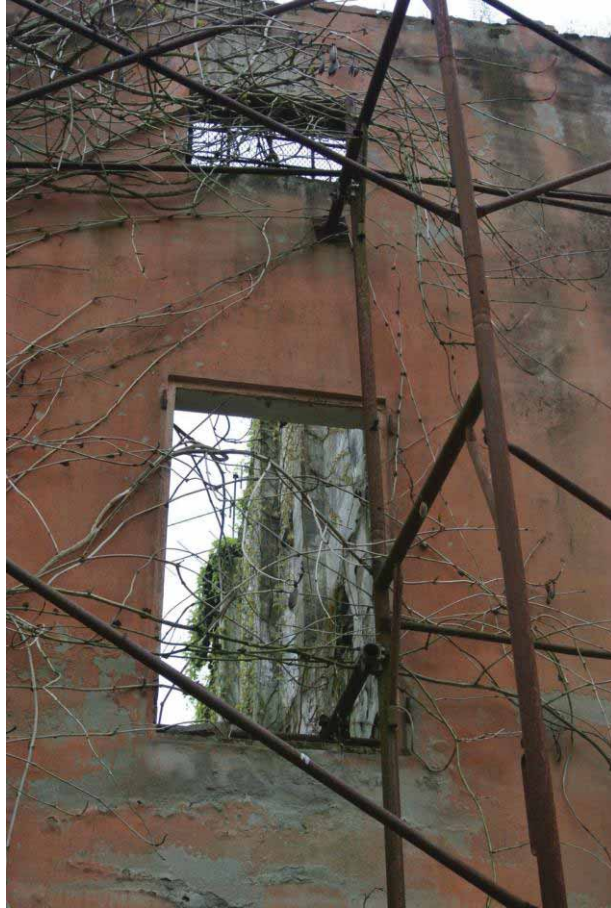
Foto 6: Prospetto ovest - particolare Crollo del coperto ligneo verso l'interno del fabbricato. Lesioni e crolli localizzati della muratura portante nella parte sommitale
